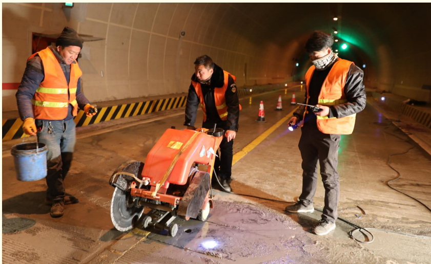
冬日的玉树草原早已是冰天雪地,地处4200米海拔、有着长江源头第一高海拔隧道之称的紅土山隧道,经常发生排水管因冰冻堵塞渗水的问题。负责修建这条隧道的中铁五局疏
