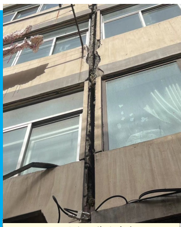
图为开裂的外墙。
