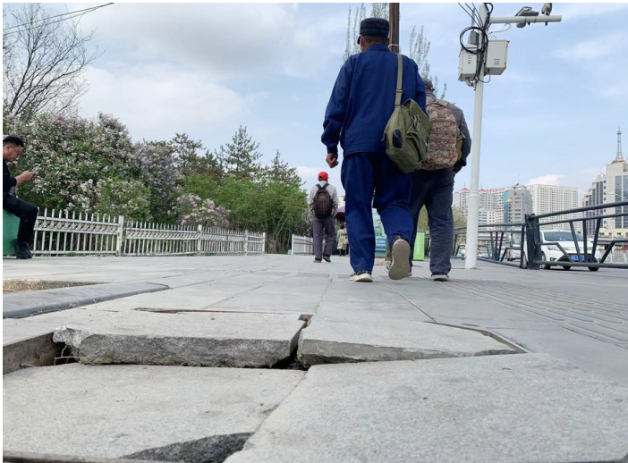
5月6日,有热心市民反映,南川东路西侧南山路西口公交车站附近,一窨井的混凝土井盖破碎,存在安全隐患。 曙光摄
