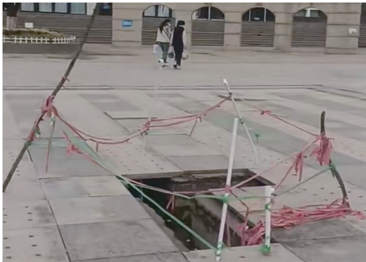
近日,有微友反映,湟中区圣山国际广场上的几块地,出现大坑,半年多了一直没人处理,不仅存在隐患,也影响城市形象,希望相关部门可以尽快修复。 微友 杂汪哥福 摄
