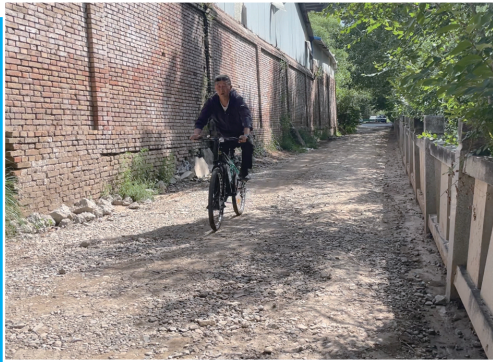
路况关注 图为南川河东侧人行步道坑洼不平的现状。
