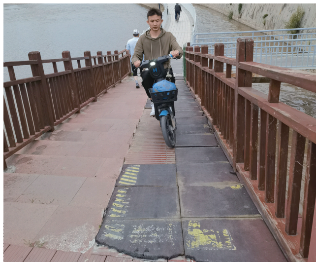
近日,市民反映,秀水路通往海西东路河边景观桥北端坡道上一大半的防滑垫已松动,甚至脱落,一直没有维修,存在安全隐患。
