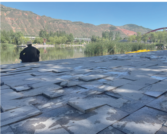
图北川湿地公园地砖破损的情景。
