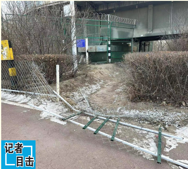
12月18日,记者在北禅路看到,绿道旁的防护网部分损坏严重,根本起不到防护作用,希望相关部门能够及时修复。 苑柠摄
