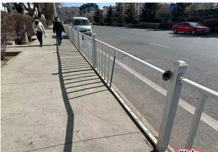
近日,记者在奉青路看到,奉青路口公交站附近的人行道护栏部分缺失,护栏一头的连接处断裂,存在安全隐患,希望相关部门能够及时修复。 苑柠 摄
