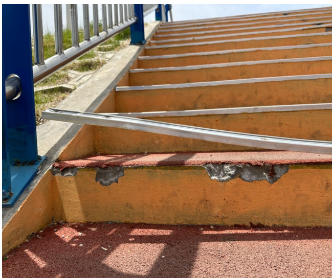
近日,记者在秀水路城市公园通向七一西路的楼梯上看到,五六条楼梯防滑条脱落、翘起,行人稍不注意会被绊倒,希望相关部门能够及时修复。 苑柠 摄
