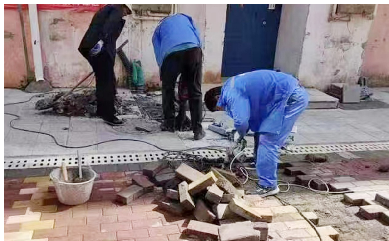
宏园二区基础设施改造后，有一处污水井高于排水管道，导致污水倒灌进小区12楼1单元地下室和一楼商铺，影响居民正常生活。接到反映后，石坡街社区工作人员联系施工方采取措施，从源头上解决了污水倒灌问题。
