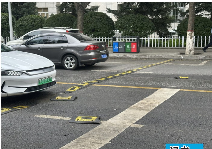
近日,记者在市世纪职业技术学校门前看到,道路上的减速带松动移位,起不到减速的作用,还影响过往车辆通行,希望相关部门能够及时修复。 苑柠 摄
