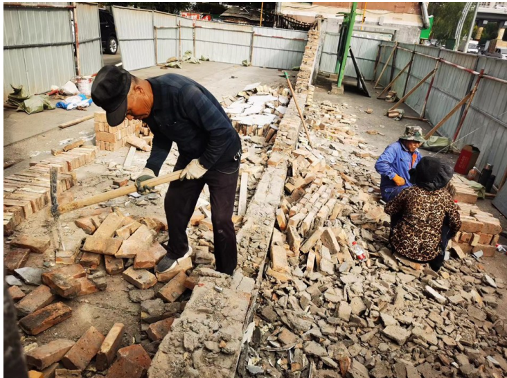
近日,九场家属院居民向汽运社区反映,他们小区一围墙倾斜,给居民出行带来安全隐患。9月3日,社区查看后决定启用服务群众专项经费拆除重建,预计9月9日完工。
