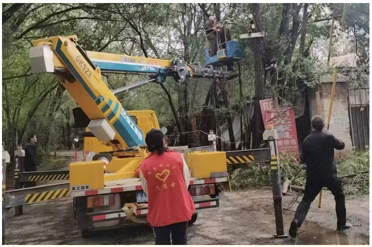
近日,西杏园社区工作人员巡查时发现,一厂区内2棵树木倾斜,树枝触碰高压电线后引发火灾。社区迅速联系供电局及厂区负责人协商,决定对这2棵树木进行修剪,及时解除风险,确保居民安全。 傅臻 摄
