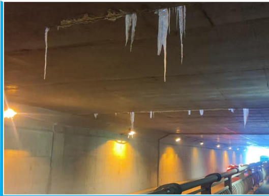
图为站东巷涵洞顶部的冰锥。
