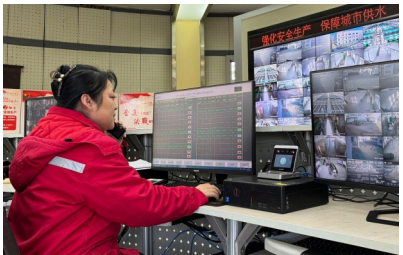
西宁供水集团第七水厂净化运转一组 曹慧
