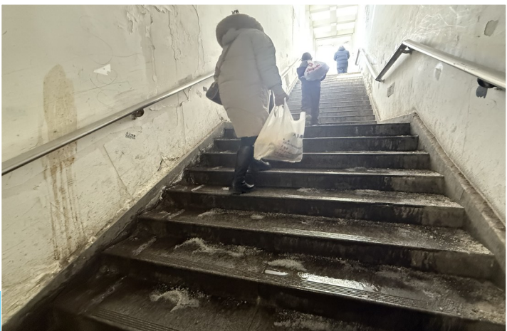
图为地下通道出入口楼梯积水、结冰,墙皮脱落的情景。
