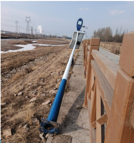
图为太阳能路灯倒在河边的场景。
