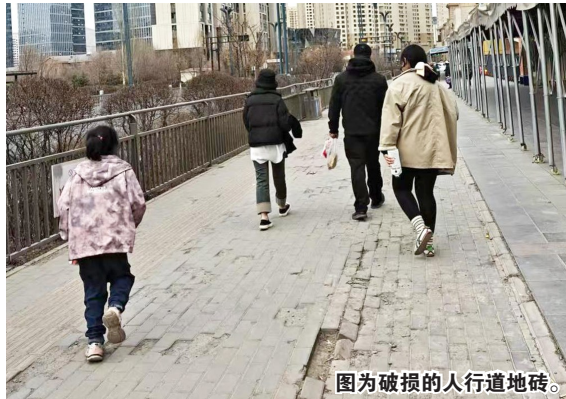
图为破损的人行道地砖。
