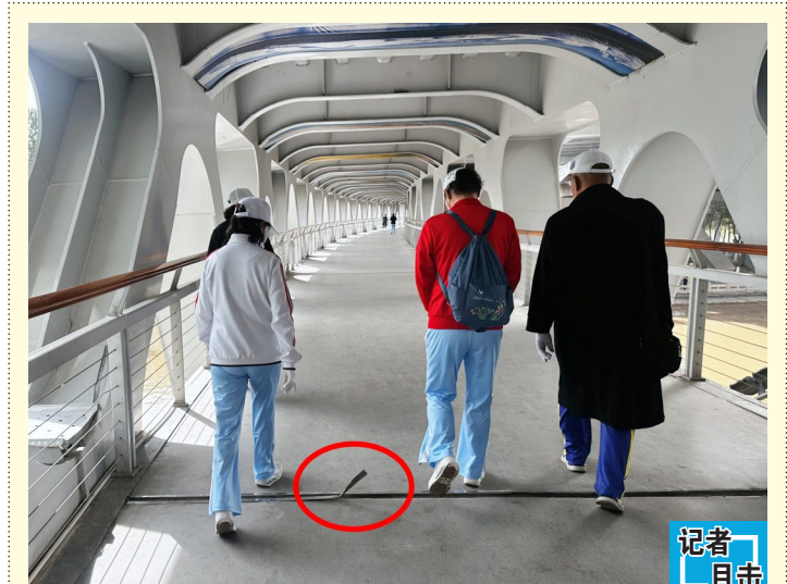
5月16日,记者在昆仑桥北侧人行通道看到,路面上铺设的部分金属条缺失或翘起,路过的行人稍不注意就会被绊倒,存在安全隐患,希望相关部门能够及时修复。 记者 门目 苑柠 摄
