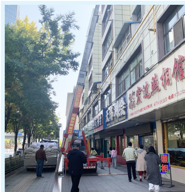
10月31日12:10，记者在胜利路南侧看到，临街居民楼前一辆吊车在未采取任何防护措施的情况下往楼上吊装装修用的水泥、砂石，此时恰是学生放学的时间，行人、学生只能在吊车下穿行，存在安全隐患。俸臻摄
